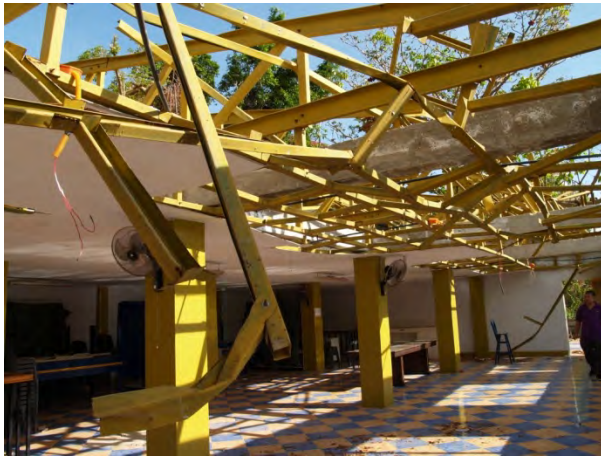
P. Bogs zeigt uns das zerstörte Dach der Bibliothek
